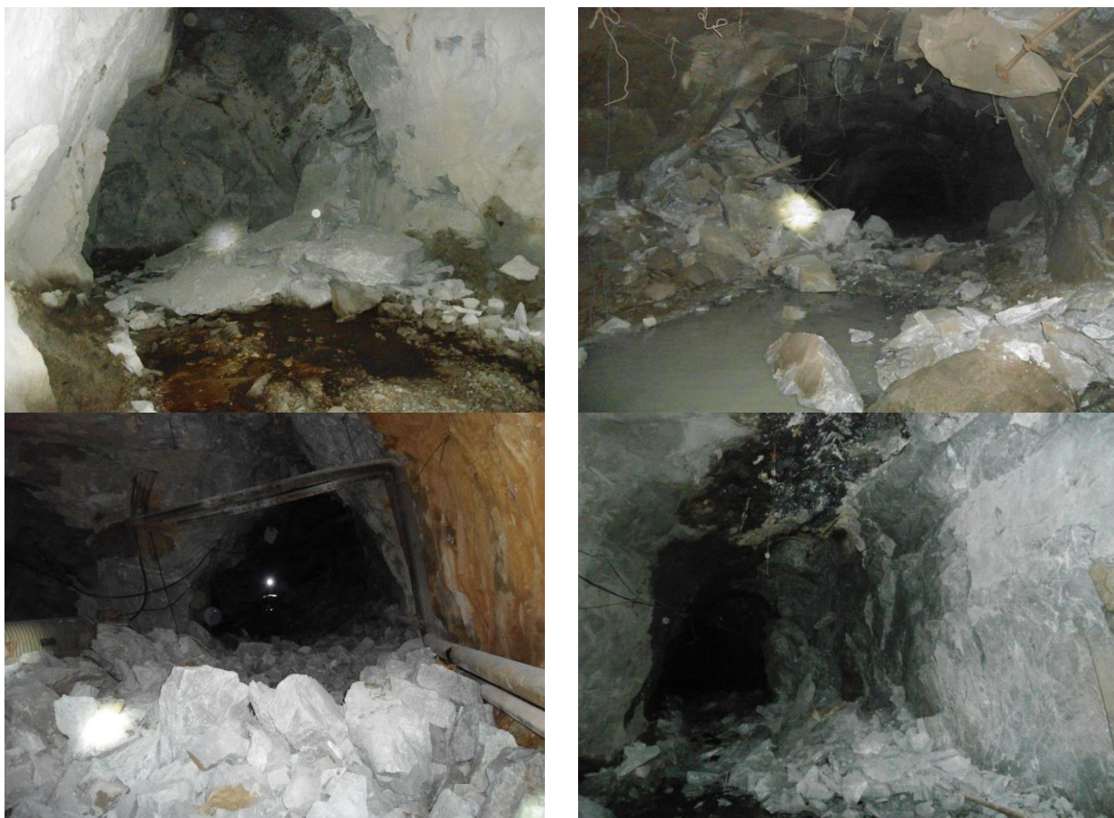
Рисунок 1.1.2 – Последствия геодинамических явлений, зарегистрированных 30.10.2015 и 25.03.2016 на Николаевском месторождении
