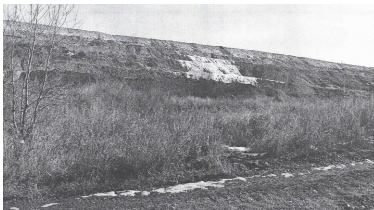
Рис. 2 – Выход фильтрационных вод ограждающей дамбы
